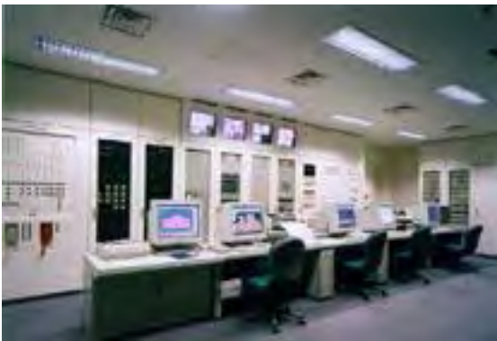
防災センター
